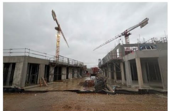
190 logements sont attendus à l'angle des avenues Jaurès et Roosevelt, à Décines-Charpieu. Photo Olivier Philippe
