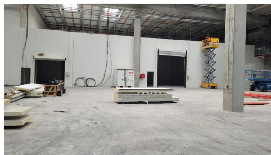
Le nouveau bâtiment est équipé d'une cellule « froid » de 4 900 m 2 qui offre un potentiel de développement énorme pour WFS. (Photo A.R.)
